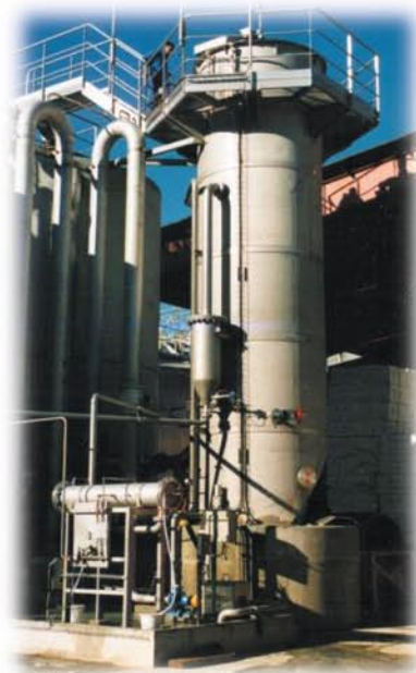
MCV 20 - Очистка краскосодержащих сточных вод (после процесса ДЕИНКИНГ).
