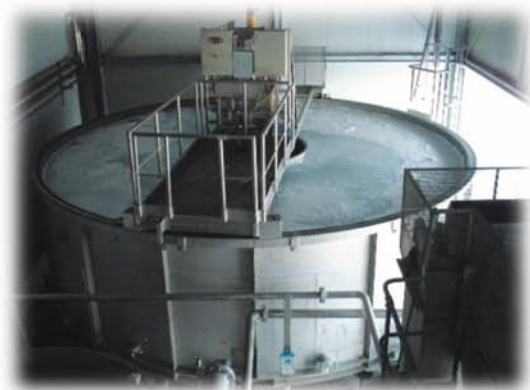
KLC 24 - Система подготовки питьевой воды.
