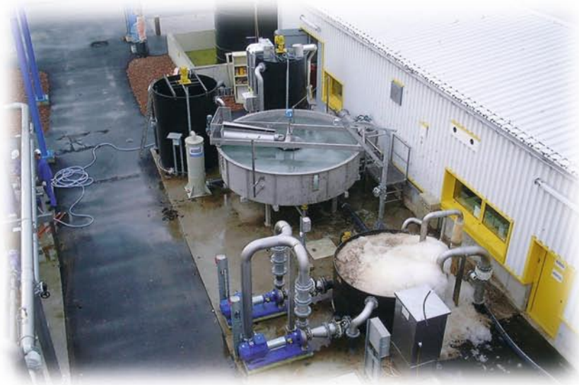
MNC 12 - Очистка стоков сахарного завода.
